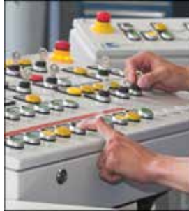
Neueste SPS und Fahrüberwachung (z.B. Pilz oder Allen-Bradley) Newest PLC system and monitoring (e.g. Pilz or Allen-Bradley)
